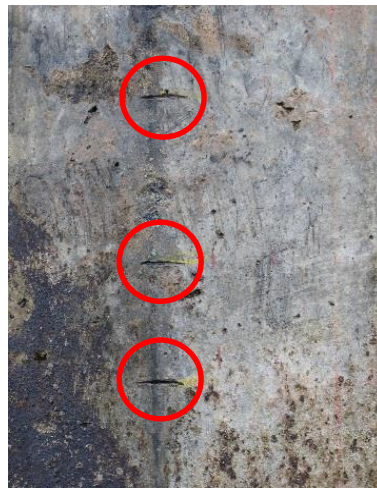
Figure 2-16 : Photographie des « encoches » permanentes indiquant les armatures horizontales sur l'arête d'une face de pile.
