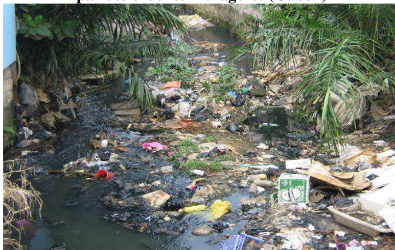
Photo 42 : Obstruction du lit du bassin versant de la Gué Gué par des ordures ménagères (Gabon)
