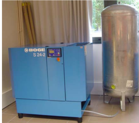
Figure 51 : Compresseur et réservoir d'air
