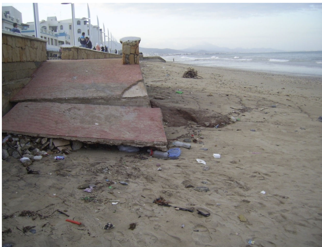
Figure III. 52– Destruction d'une partie d'escaliers de la corniche de M'diq (cliché pris le 25-10-2008 après des tempêtes qui ont persisté jusqu'au 23-10-2008, il est à noter qu'on a enregistré une hauteur de 6m pour H_s associée à une période de 10,2s le 11 octobre 2008 selon les enregistrements du point Wana 2006006).
