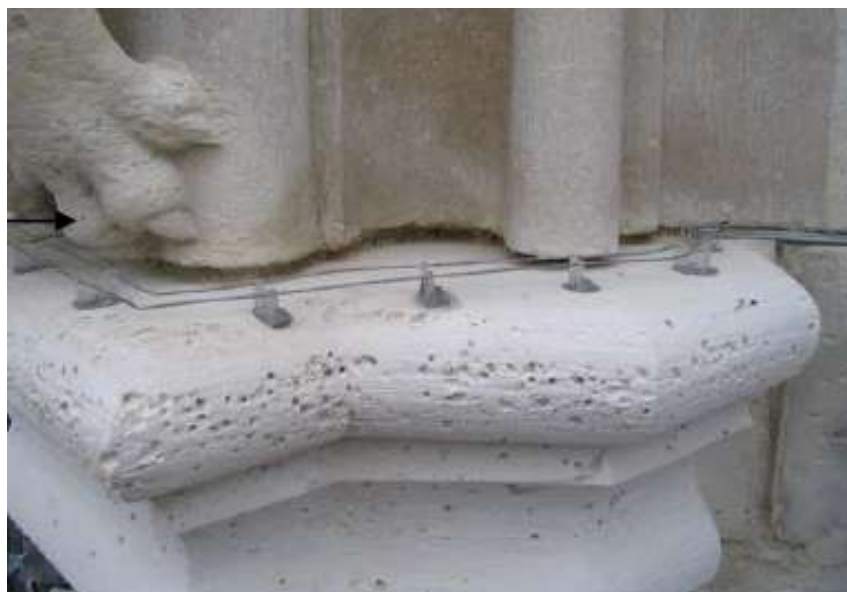
Figure 24 : corniche de Notre Dame de Paris équipée du système d'électro-répulsion (Broussois, 2005)
