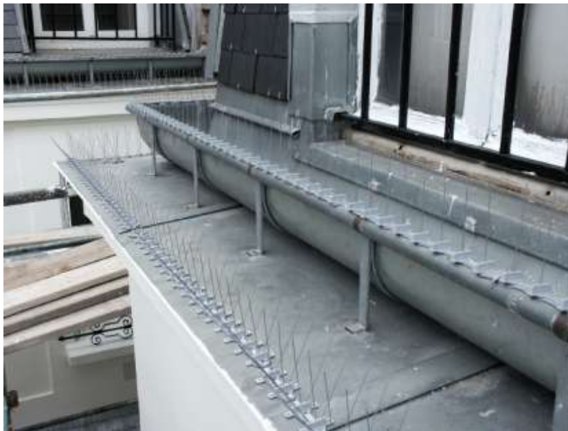
Figure 21 : pics anti-pigeons posés au niveau d'une gouttière (simples) et d'une corniche (doubles). (21)
