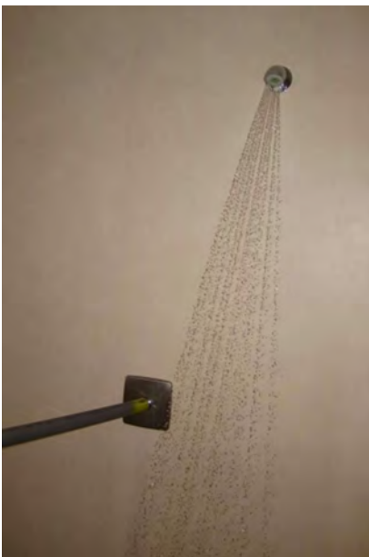
Figure 22. Purge de la douche fixe avec la "canne" adaptée
