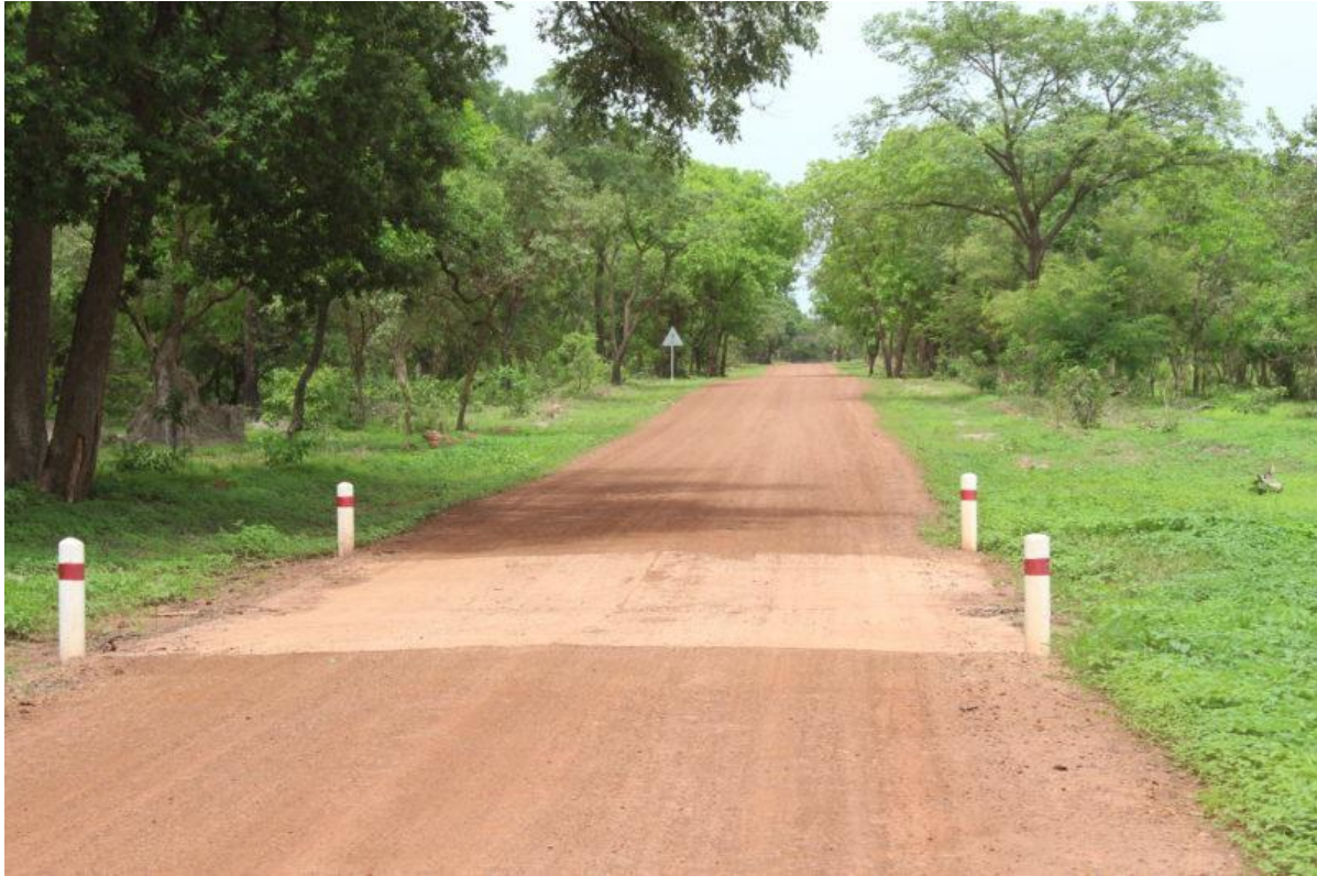
Photo 6 : Piste rurale menant vers les axes routiers Brin-Séléky dans la région de Ziguinchor. Source : PPDC, 2016
