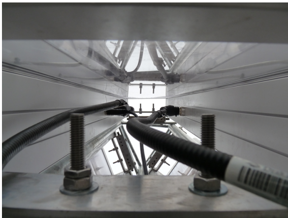
(a) Câbles RF
