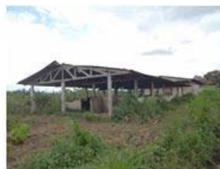
Photo n°1.2: Une vue d'un bâtiment annexe abandonné de la SODERIM
