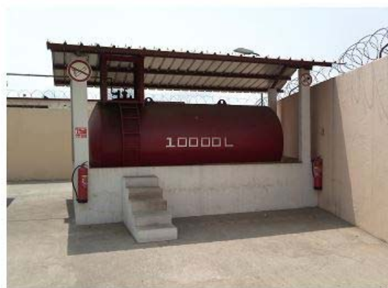
Photo n°7.2 : Une vue de la citerne permettant d'alimenter le groupe électrogène au port d'Owendo au Gabon
