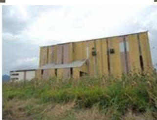
Photo n°1.3: Une vue du bâtiment principal en état de dégradation et envahi d'herbes de la SODERIM
